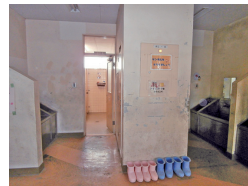
改修されず古いままのトイレ
